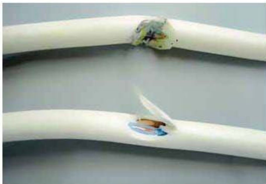
Мал. 191. Зовнішній вигляд проводу з пошкодженим ізоляційним шаром
