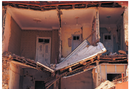
Мал. 26.1. Руйнівні наслідки землетрусу
