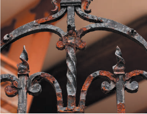
Мал. 60.4. Корозія металевої конструкції воріт
