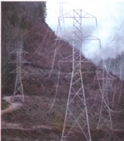
Опори ліній електропередачі
