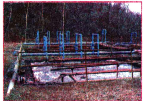
Рис. 39.2. Невелика водоочисна споруда
